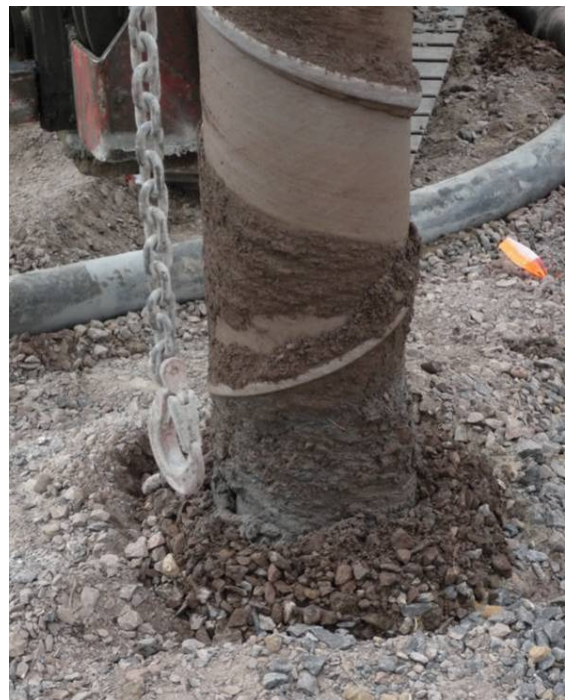
Abb. 5 Leichte Aufwölbung des Bodens an der Oberfläche
